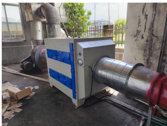
图 4-1 混炼、挤出废气活性炭处理装置#1
