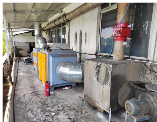
图 4-2 混炼、挤出废气 UV 光氧+活性炭处理装置#2
