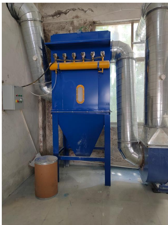
图 4-3 投料、拌料工艺布袋处理装置#1
