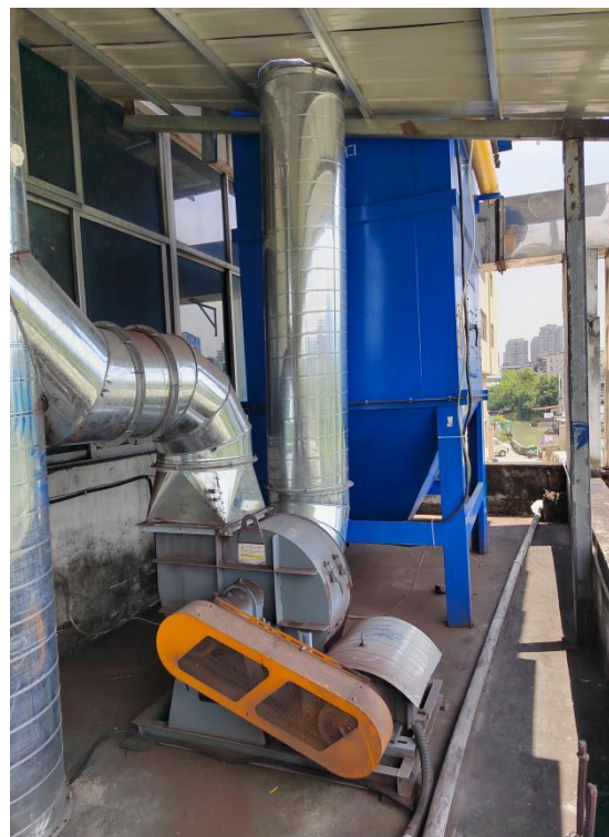
图 4-4 投料、拌料工艺布袋处理装置#2
